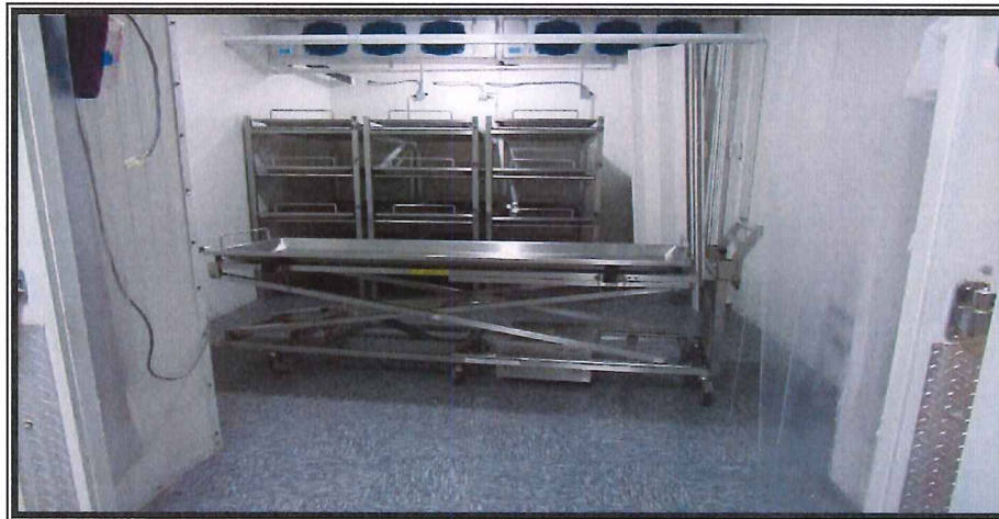
Cámara frigorífica. Repositorio de cadáveres
