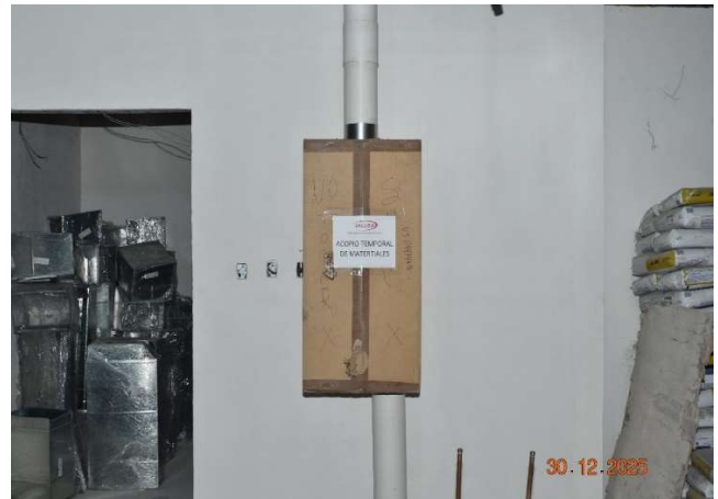
Instalación de estación de envío neumático
